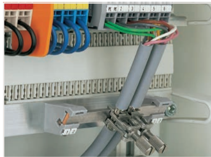
2 yalıtımlı taşıyıcı (790-100) üzerinde ortak potansiyelli ekranlama modülleri
